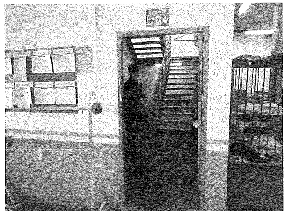
22. ประตูหนีไฟและทางหนีไฟ
