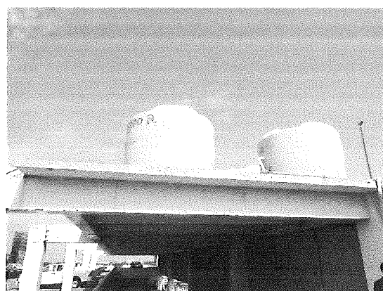
14. ถังเก็บน้ำ ระบบประปา
