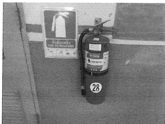
35. อุปกรณ์ดับเพลิงแบบมือถือ
