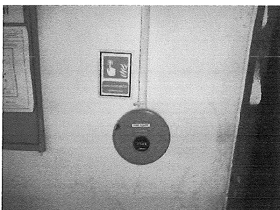
29. อุปกรณ์แจ้งเหตุเพลิงไหม้
