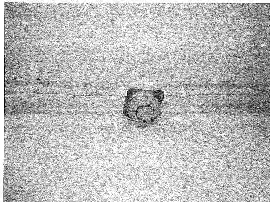
32. อุปกรณ์ตรวจจับควันแจ้งเหตุเพลิงไหม้
