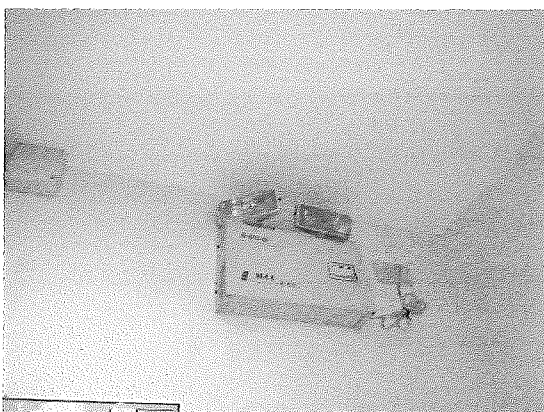
27. ไฟฉุกเฉิน
