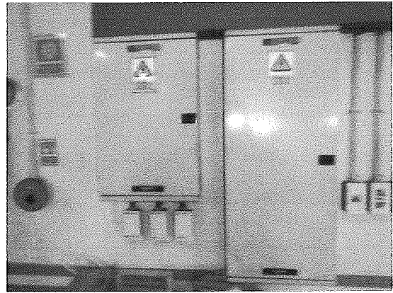
10. ตู้ไฟฟ้า LOAD PANEL
