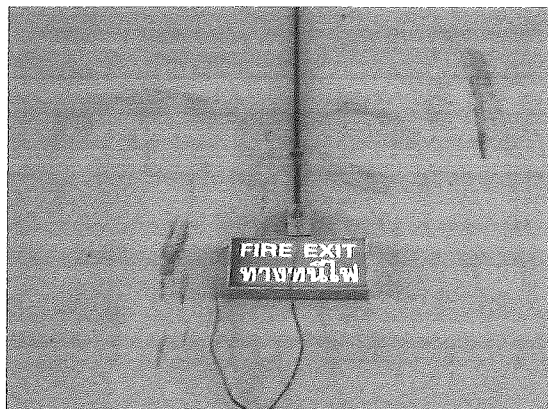
25. ป้ายไฟทางออกฉุกเฉิน
