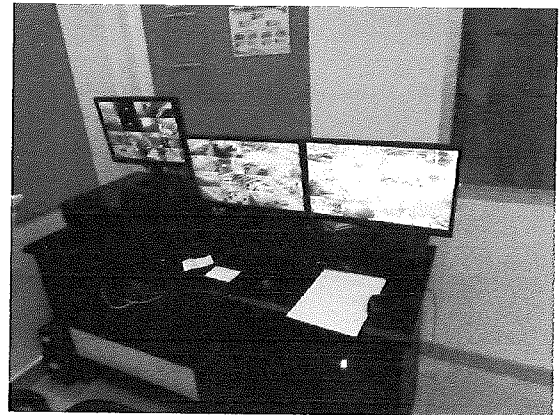
40. ระบบ CCTV
