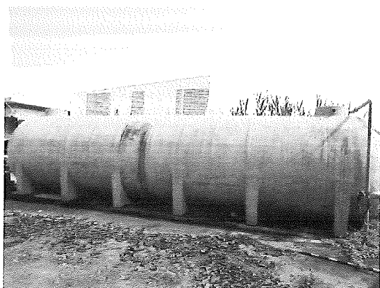
13. ถังเก็บน้ำ ระบบประปา
