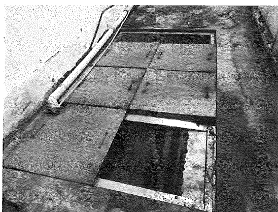
15. ระบบบำบัดน้ำเสีย
