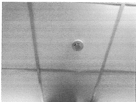
31. อุปกรณ์ตรวจจับควันแจ้งเหตุเพลิงไหม้
