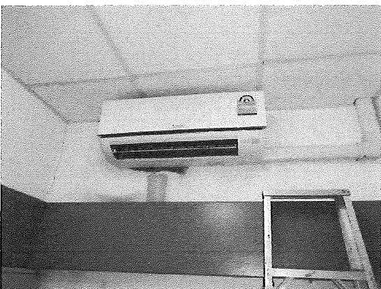
11. อุปกรณ์ระบบปรับอากาศ
