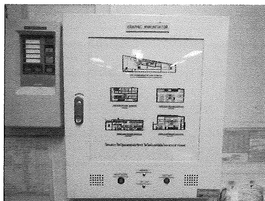
34. ตู้แสดงผล อุปกรณ์แจ้งเหตุเพลิงไหม้
