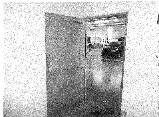
24. ประตูหนีไฟและทางหนีไฟ
