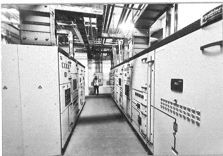
ระบบไฟฟ้า
