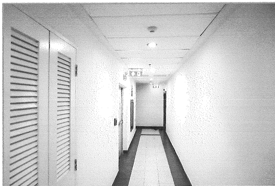
ระบบแจ้งเหตุเพลิงไหม้อัตโนมัติ
