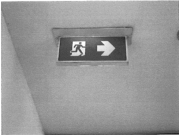
9. ป้ายทางออกฉุกเฉิน
