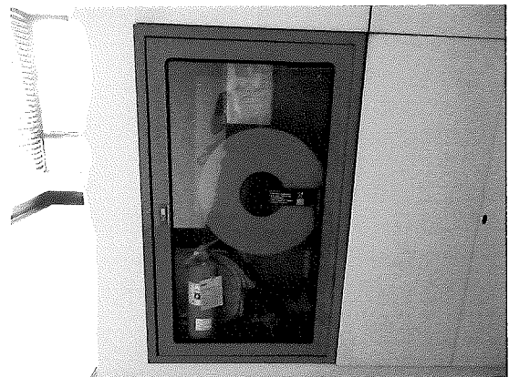
4. ตู้อุปกรณ์ดับเพลิง สายฉีดน้ำดับเพลิง
