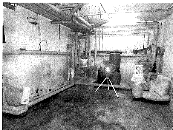
20. ห้องปั้มน้ำของสระว่ายน้ำ
