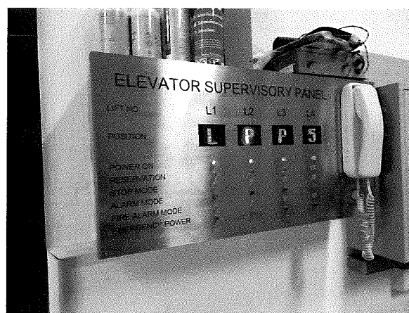
22. ตู้ควบคุมระบบลิฟต์ภายในอาคาร
