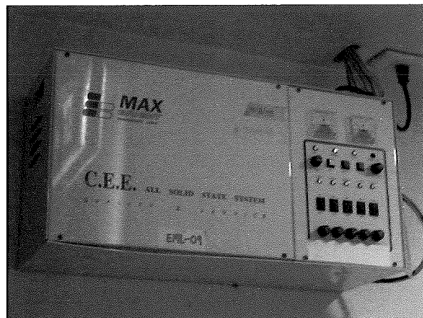
16. ตู้ควบคุมไฟฉุกเฉิน
