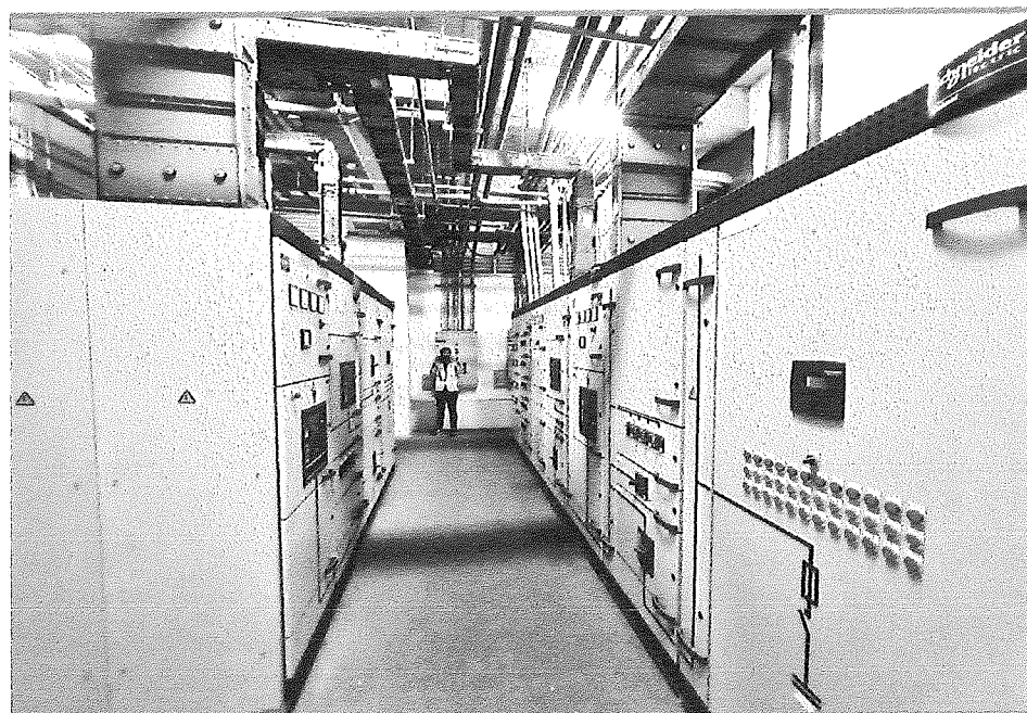
ระบบไฟฟ้า
