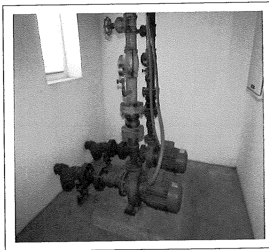
เครื่องสูบน้ำเพิ่มความดัน (Transfer Pump)
