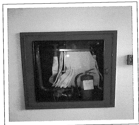
ตู้สายฉีดน้ำดับเพลิง (Fire Hose Cabinets)
