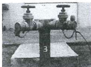
รูปแสดง FIRE HYDRANT
