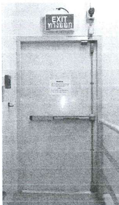
รูปแสดง FIRE EXIT DOOR
