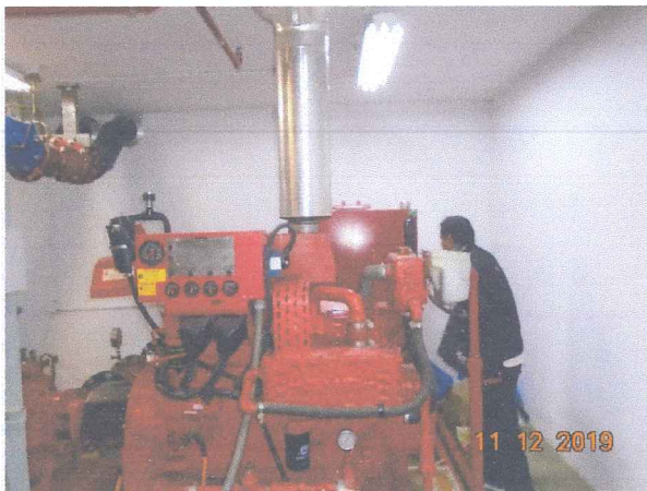
การตรวจสอบสภาพเครื่องสูบน้ำดับเพลิง
