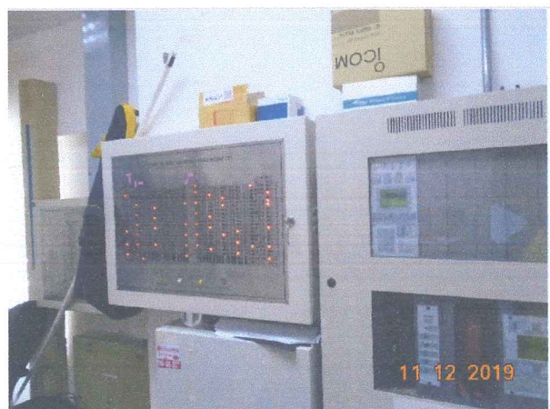
การตรวจสอบสภาพตู้ควบคุมระบบแจ้งเหตุเพลิงไหม้
