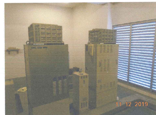
การตรวจสอบสภาพโทรศัพท์ฉุกเฉินภายใน ห้องควบคุมระบบขับเคลื่อน
