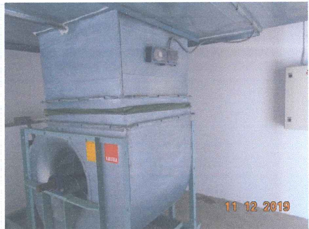
การตรวจสอบสภาพระบบอัตโนมัติภายในบันไดหนีไฟ
