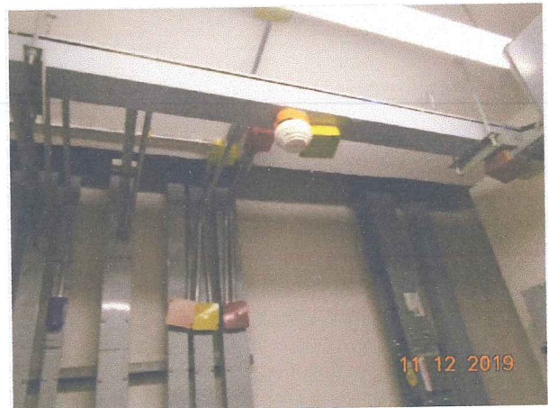
การตรวจสอบสภาพการเดินสายไฟภายในอาคาร
