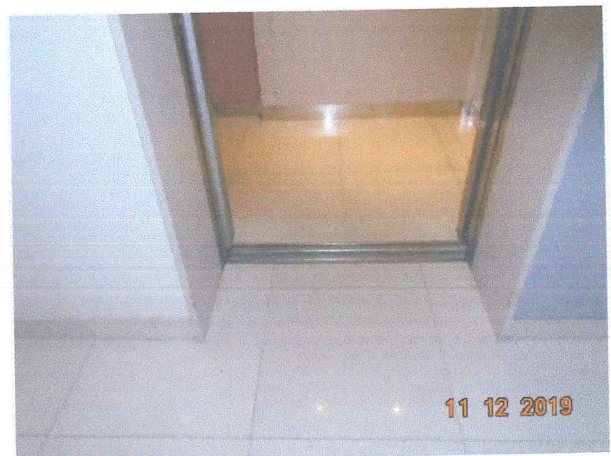
การตรวจสอบสภาพการจอดตรงชั้น
