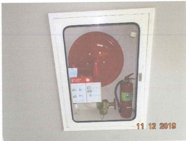
การตรวจสอบสภาพตู้สายฉีดน้ำดับเพลิงและถังดับเพลิงมือถือ
