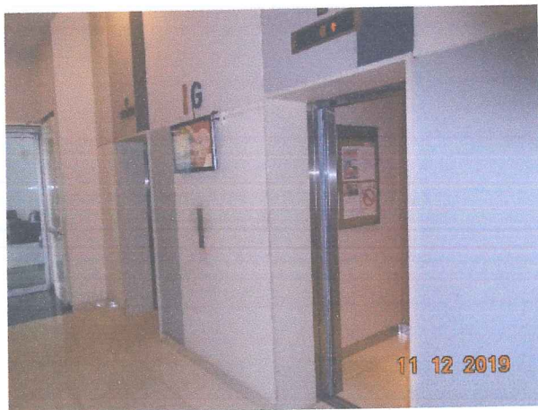
การตรวจสอบสภาพระบบป้องกันประตูหนีบของลิฟต์โดยสาร
