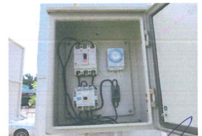
แผงควบคุมไฟฟ้า
