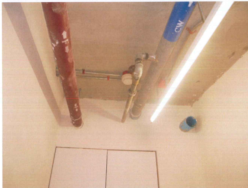
รูปห้องพักขยะภายในอาคาร มีการปิดล้อม และควบคุมความสะอาด
