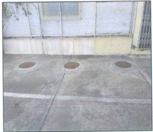
-บ่อบำบัดน้ำเสีย
