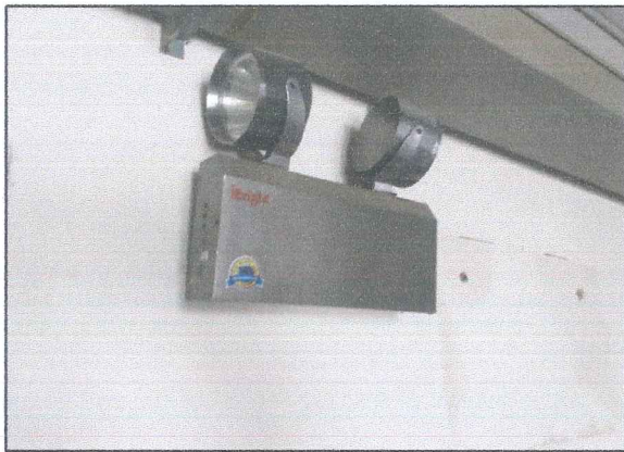
-อุปกรณ์ไฟฉุกเฉิน
