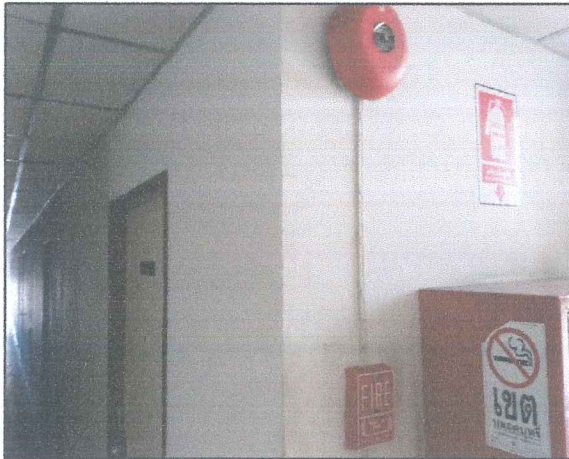
-อุปกรณ์แจ้งเหตุฉุกเฉิน
