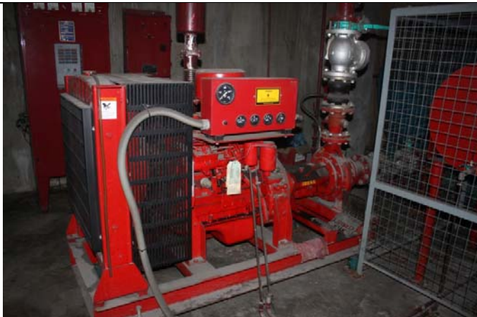
ปั้มน้ำดับเพลิง
