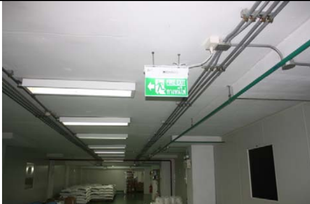
ป้ายทางหนีไฟ
