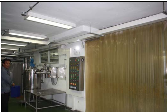
ไฟฉุกเฉิน
