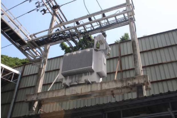
หม้อแปลงไฟฟ้า
