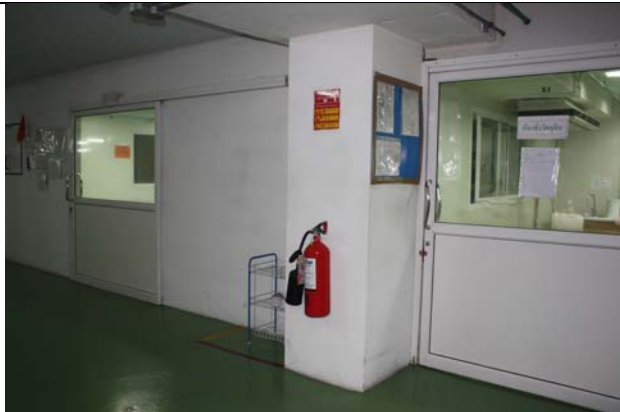
ถังดับเพลิง
