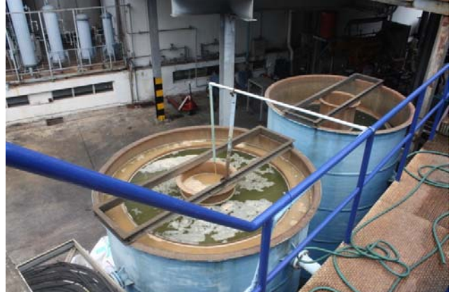
บ่อบำบัดน้ำเสีย
