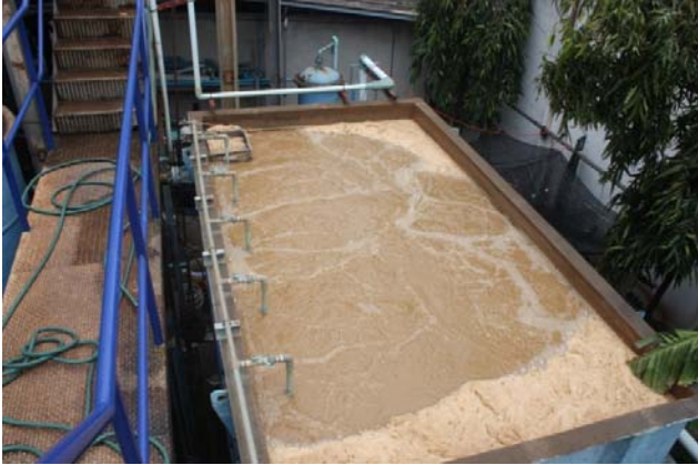
บ่อบำบัดน้ำเสีย
