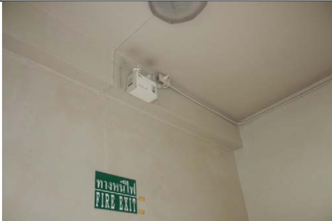
ไฟฉุกเฉินติดทางบันได
