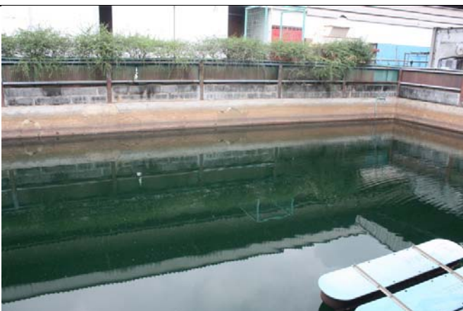
บ่อบำบัดน้ำเสีย
