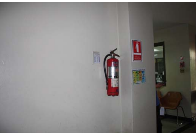
ถังดับเพลิง
