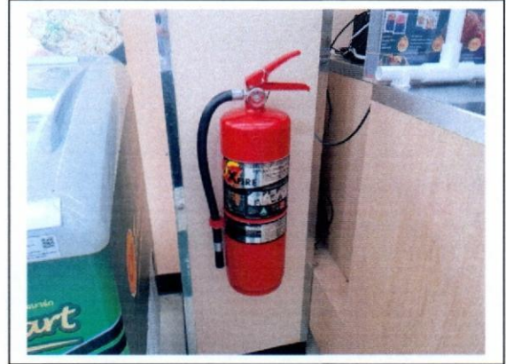
เครื่องดับเพลิงแบบมือถือชนิดผงเคมีแห้ง
