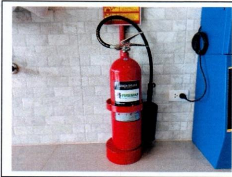
มีการติดตั้งถังดับเพลิงแบบมือถือ
