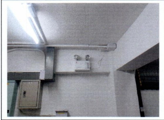
ไฟฉุกเฉิน
