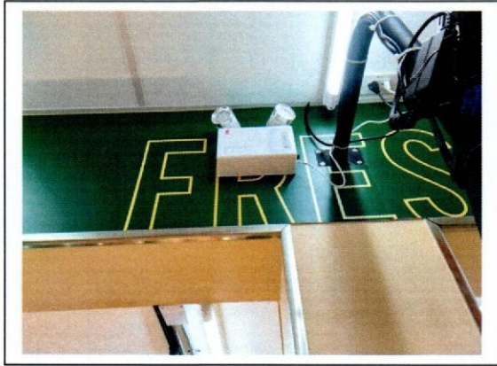
ไฟฉุกเฉิน
