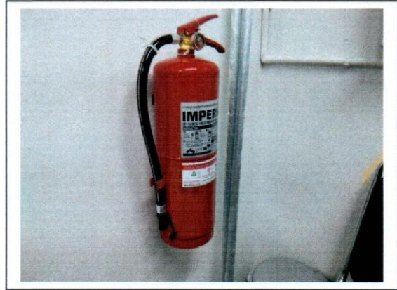
เครื่องดับเพลิงแบบมือถือชนิดผงเคมีแห้ง
