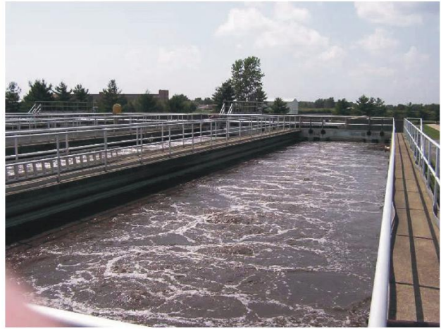
บ่อบำบัดน้ำเสีย
