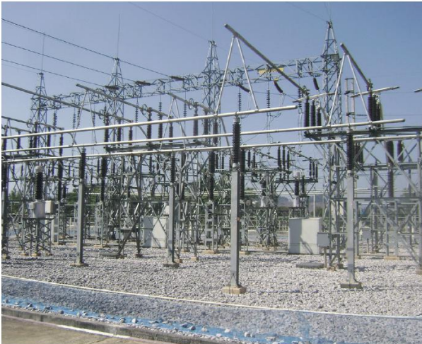
สถานไฟฟ้า
