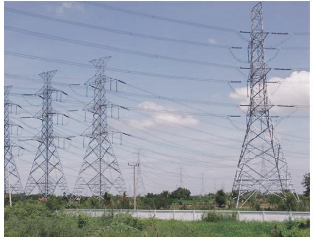
เสาไฟฟ้า
