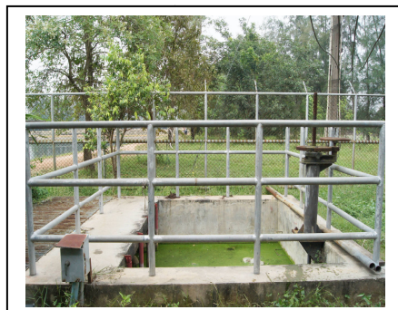
บ่อบำบัดน้ำเสียปลายทาง
