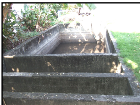
บ่อดักไขมันและขยะ ของน้ำทิ้ง ก่อนเข้าสู่บ่อกลวงเวียน
