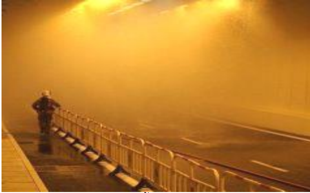
ภาพระบบฉีดน้ำดับเพลิงในอุโมงค์
